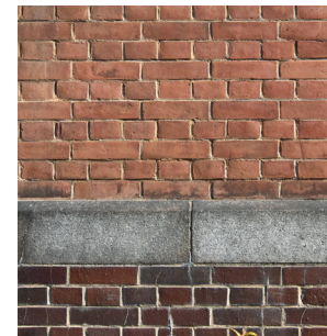
レンガは広島湾を中心とする瀬戸内海沿岸のレンガ工場から調達された。地面に近い部分は濃い色の焼過レンガが使用されている。
