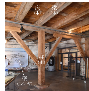
欧州の古い陸軍倉庫の例。壁はレンガ造で柱・梁・床は木造。（スオメンリンナ要塞）
