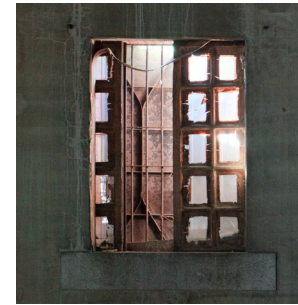
レンガ造の建物の窓は上げ下げ式か観音開きが通例だが、被服支廠倉庫の窓は横にスライドする珍しい形式。鉄格子や鉄扉は建設当初のものと思われる。
